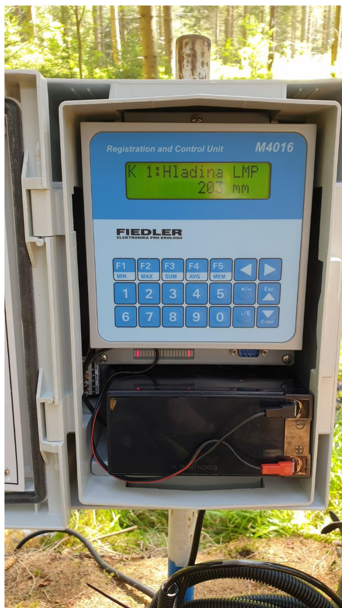
Obr. 21 Stanice je uvedena do provozu
